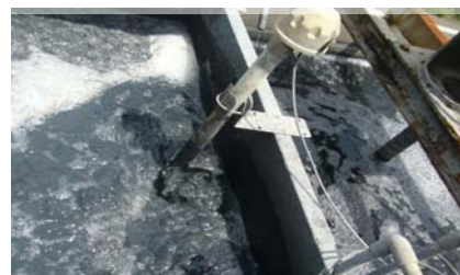
油水分離、混凝沉澱
