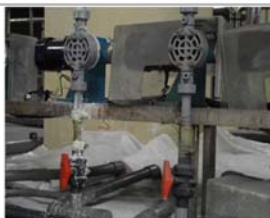
廢水加藥機接頭洩漏
