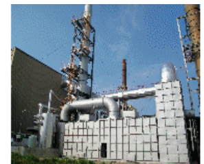
雙槽蓄熱式高溫氧化 系統(RTO)處理揮發 性有機廢氣
