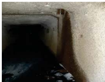
廠外廢水排放口處
