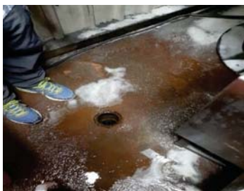
廠內廢水排放口處
