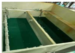
設置槽液回收槽 回收帶出液
