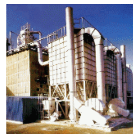
高效能集塵裝置
