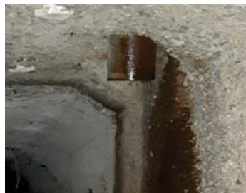
廠外廢水排放口處
