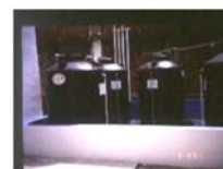
防溢堤容積足夠
