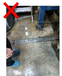
廢水處理廠地板有破損 應立即修復
