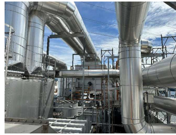
焚化設備處理
