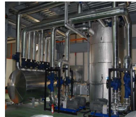
處理設備廢熱回收再利用
