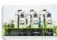
氣提循環設備
