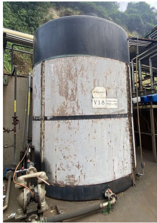
冷凝水收集槽
