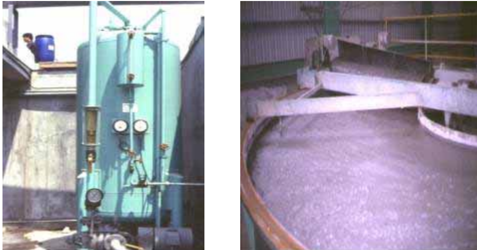
圖 2.1-11 溶氣槽與浮除槽
