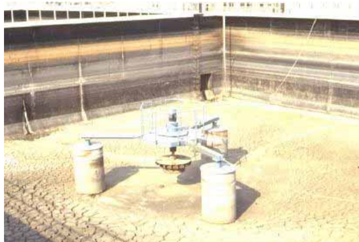
圖 2.1-6 調勻池攪拌設施與底部污泥
