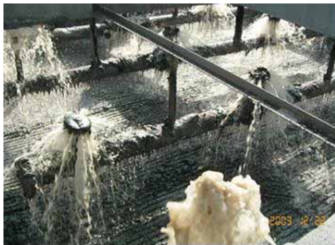
圖 2.2-4 滴濾塔內灑水狀況
