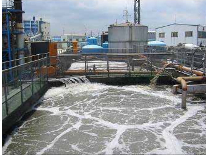
圖 2.2-1 活性污泥曝氣槽
