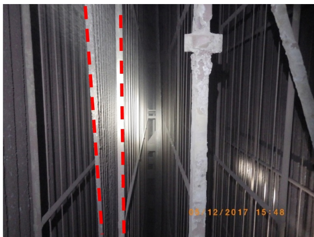
圖 12 Chamber A 第二室集板嚴重變形彎曲
