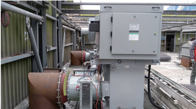
圖 11 高頻變壓整流器安裝完成
