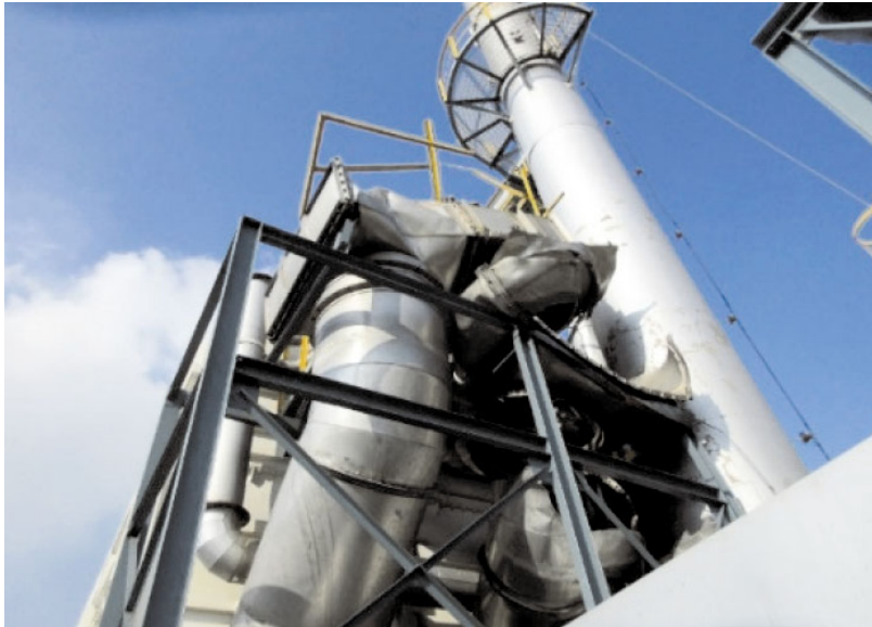
圖 8 RTO 風管管線破裂情形
