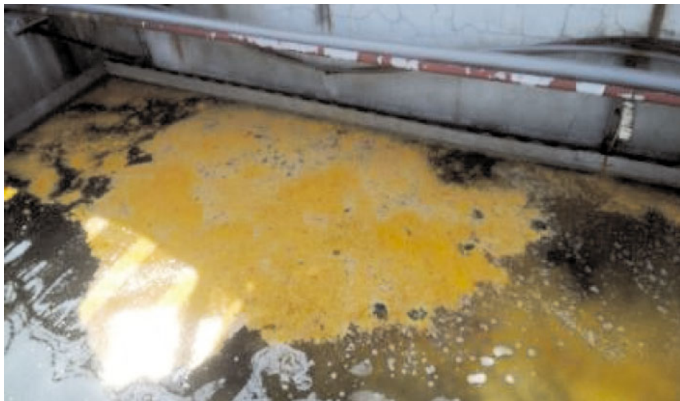
圖 4 改善前污泥沉降槽污泥上浮狀況
