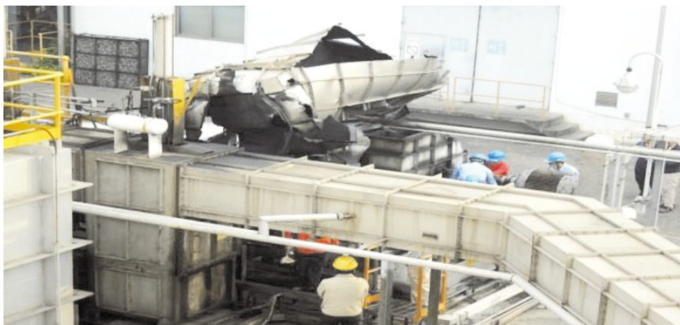
圖 7 風管管線破裂情形
