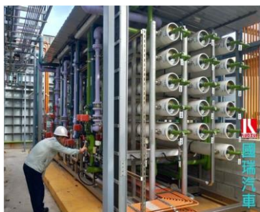
(RO 回收設備)
