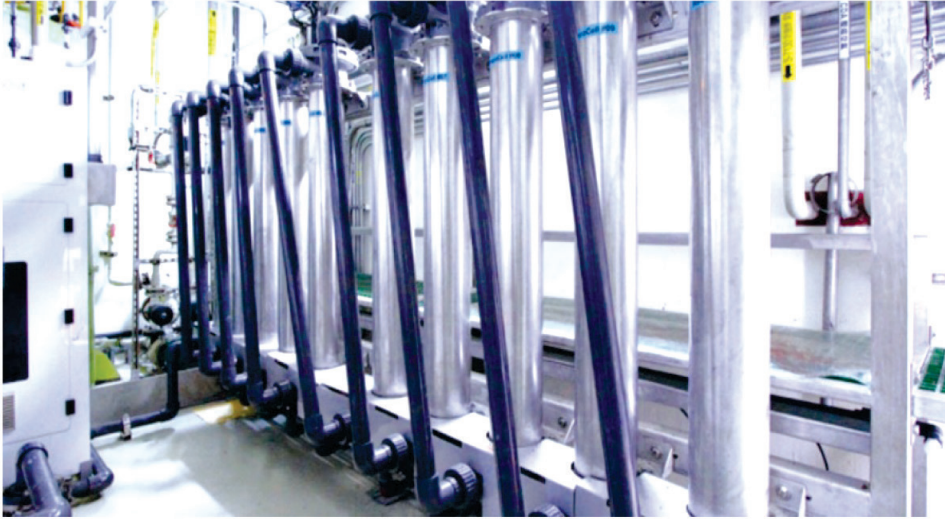
圖 4 某半導體廠之 Recocell 電解回收系統
