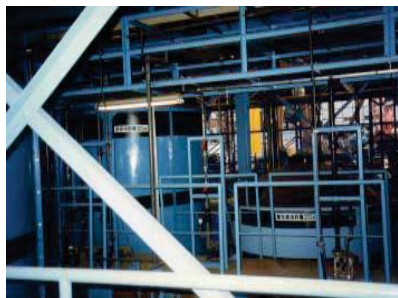
缺乏高濃度廢液儲存槽
