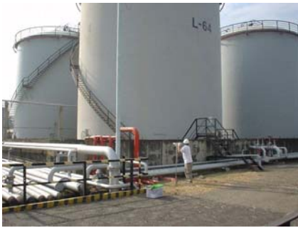
擋油堤、防溢堤
