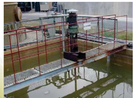
攪拌機功率不足
