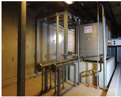
發電機油箱防溢堤
