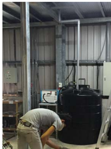
1000L 次氯酸溶液貯槽及噴霧機
