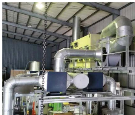
靜電集油機、送風機、次氯酸噴霧接觸槽
