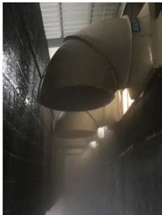
C.噴霧除臭室(進氣隔間)
