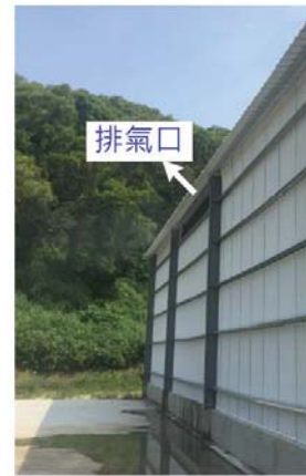
E.噴霧除臭室排氣口
