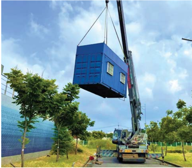
岡山橋頭污水處理廠
