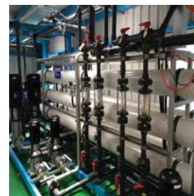
應用UF + RO高級處理 設施回收廢水再利用
