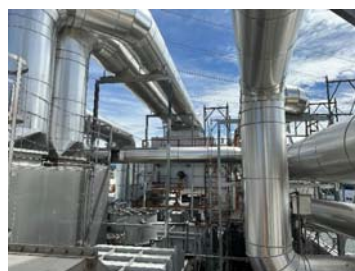
焚化設備處理
