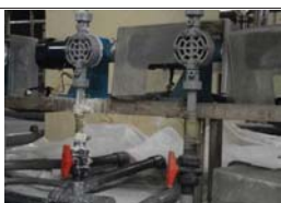
廢水加藥機接頭洩漏
