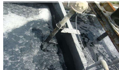
油水分離、混凝沉澱
