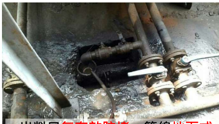
出料口無有效防堵、管線地下式
