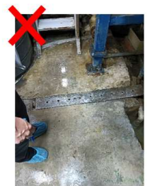
廢水處理廠地板有破損 應立即修復
