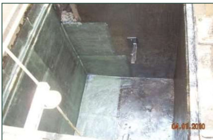
RC結構加FRP塗料 包覆之廢水暫存坑
