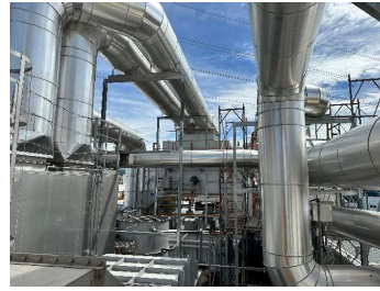
焚化設備處理
