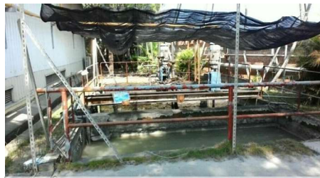
廢水槽無內覆防滲層、有破損
