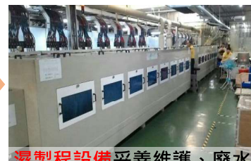
濕製程設備妥善維護、廢水明管輸送、鋪面EPOXY防護
