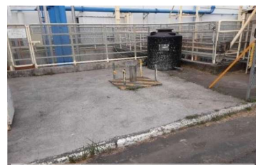
廢水槽旁地下水自主監測井
