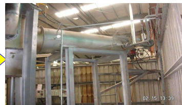
改用焚化設備處理
