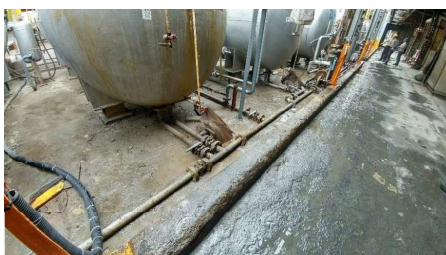
儲槽區鋪面不完整
