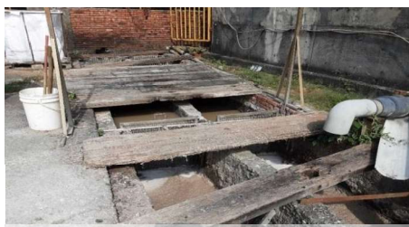
廢水以地下式排溝輸送、無防滲層
