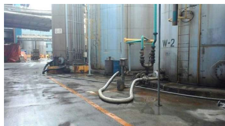
卸料口無防濺溢設施
