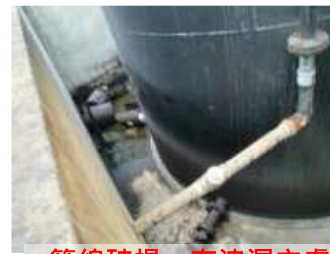
管線破損、有洩漏之虞
