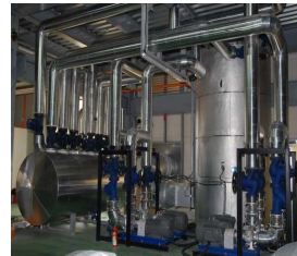
處理設備廢熱回收再利用
