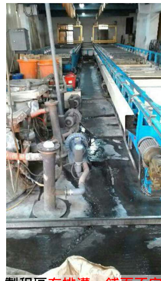
製程區有排溝、鋪面不完整
