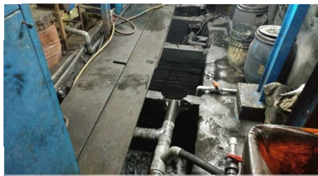
原廢水處理槽為地下式
