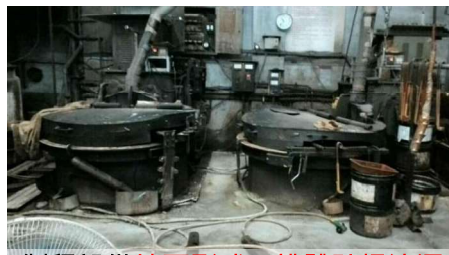
製程設備地下形式、槽體破損洩漏
