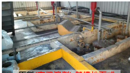
原料(有機溶劑) 儲槽地下式
