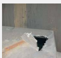
採樣口管線破洞
