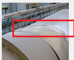
管線凹損，現場已有石灰洩出
