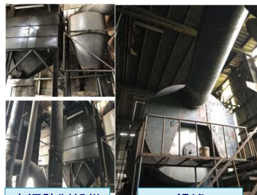
空污防制設備
