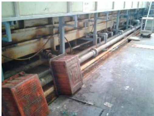
鋅系廢水收集管路
