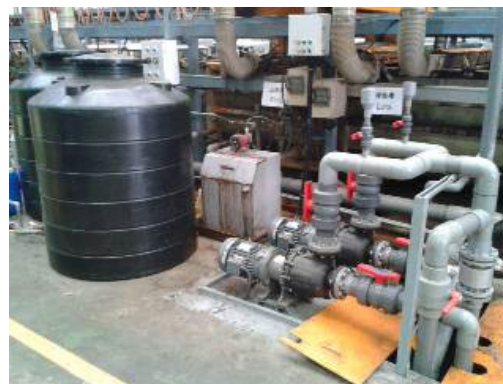
鉻系廢水集水井
