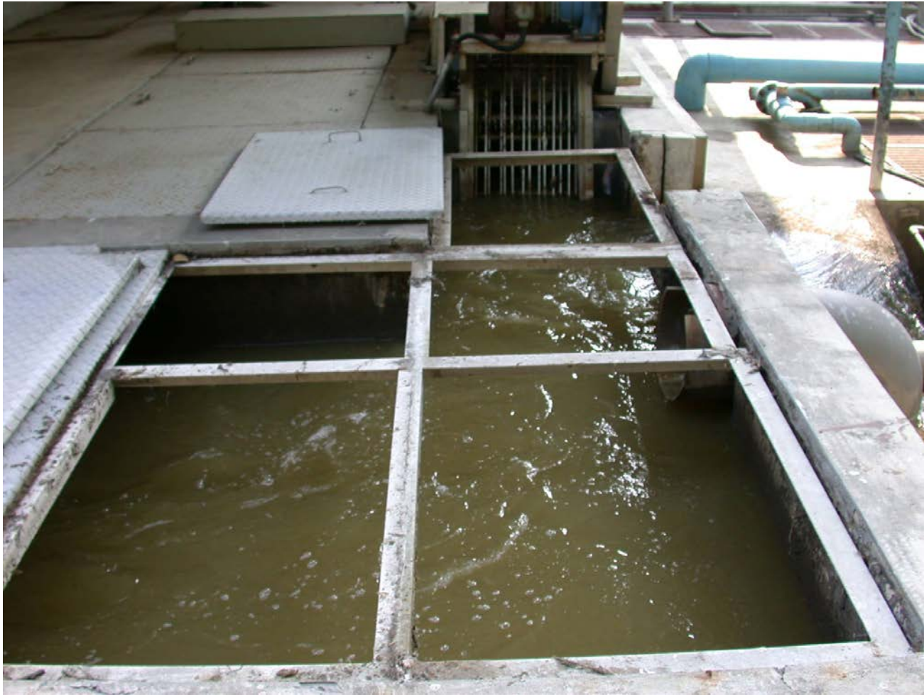
進流池及攔污柵
