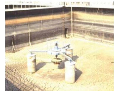
貯槽底部沉積大量污泥
