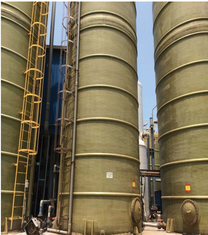
工廠自設廢水處理系統-緊急應變貯槽三座
