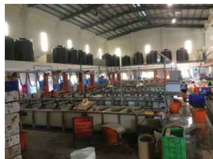
高濃度廢液貯槽
