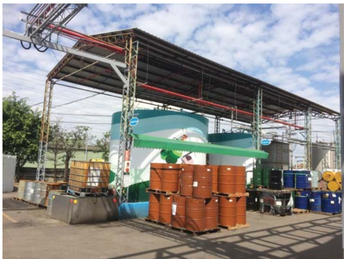
工廠自設廢水處理系統-緊急應變貯槽2座 (利用舊有油槽改裝)
