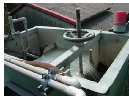
分水計量槽可迴流多餘進流水
