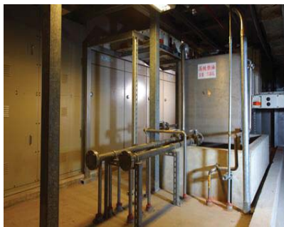
發電機油箱防溢堤
