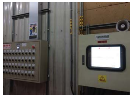
SCADA監視警報系統
