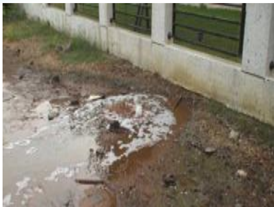
人孔冒出廢污水
