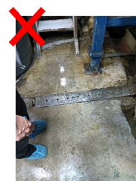
廢水處理廠地板有破損 應立即修復
