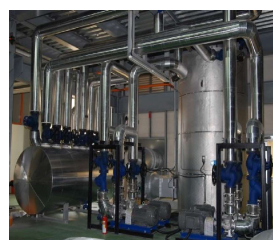
處理設備廢熱回收再利用
