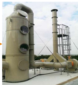
防制設備操作
