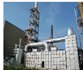
雙槽蓄熱式高溫氧化 系統(RTO)處理揮發 性有機廢氣
