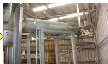
改用焚化設備處理
