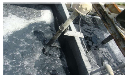
油水分離、混凝沉澱
